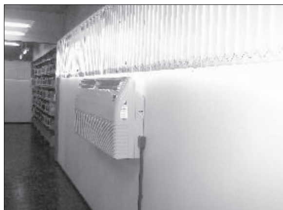
Figura 8. Detalhe do equipamento de ar condicionado e das persianas.
