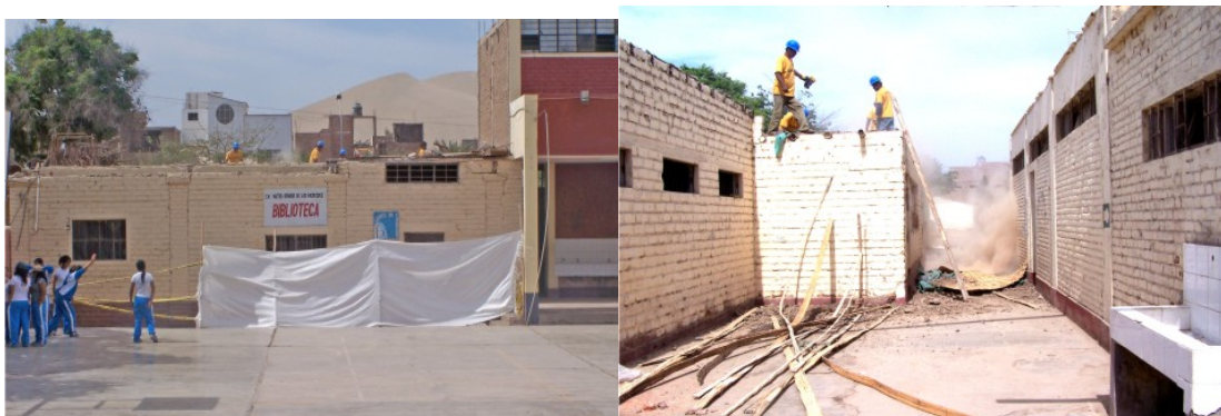
Demolición Biblioteca Escolar CN Nuestra Señora de la Merced Fuente: Orlando Corzo
