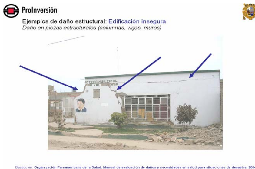
Modelo evaluación de daños en infraestructura Elaboración: Alejandro Ponce
