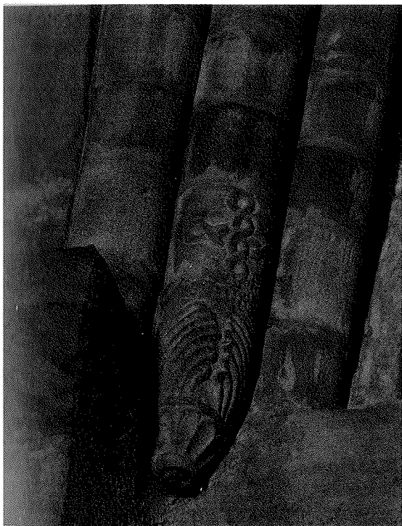
Detalle decorativo de los nervios del crucero (Foto J. M. Fernández Hevia y M. J. Villaverde Amieva).
